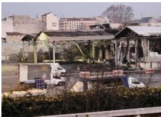
A destra le fiamme che hanno avvolto i due capannoni di via Lombroso prima dell'intervento dei vigili del fuoco A sinistra i danni alle strutture
